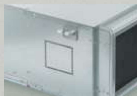
Подмес свежего воздуха, плenum под фильтр
