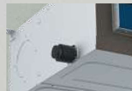
Вывод дренажа с двух сторон
